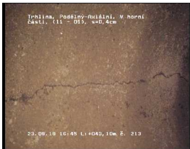
Foto 213 Videopáska: 7/8 Stav RL-O 43,10 m 11 - 1 Uhr Trhlina, Podélný-Axiální, V horní části, Šířka trhliny = 0,40cm
