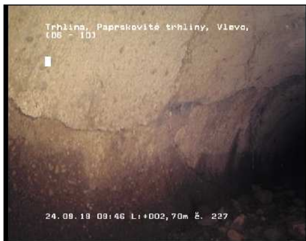
Foto 227 Videopáska: 7/11 Stav RX-L 2,70 m 6 - 10 Uhr Trhlina, Paprskovité trhliny, Vlevo
