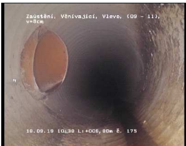
Foto 175 Videopáska: 7/4 Stav SE-L 9,80 m 9 - 11 Uhr Zaústění, Včnivající, Vlevo, Včnivající = 8cm
