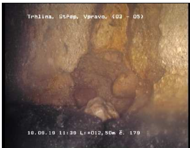
Foto 179 Videopáska: 6/2 Stav RS-R 12,50 m 3 - 5 Uhr Trhlina, Střep, Vpravo
