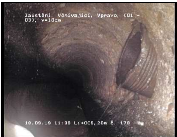
Foto 178 Videopáska: 6/2 Stav SE-R 9,20 m 1 - 3 Uhr Zaústění, Včnívající, Vpravo, Včnívající = 10cm
