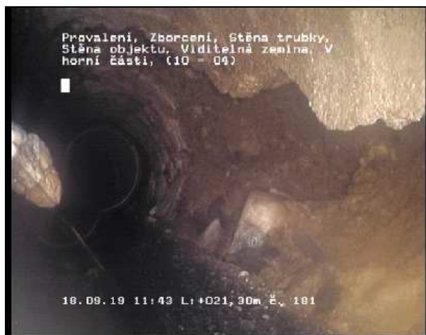
Foto 181 Videopáska: 6/2 Stav BWBO 21,30 m 10 - 4 Uhr Provalení, Zborcení, Stěna trubky, Stěna objektu, Viditelná zemina, V horní části
