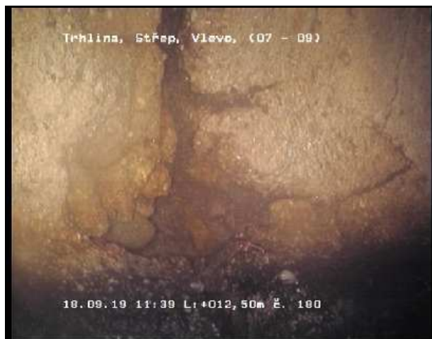
Foto 180 Videopáska: 6/2 Stav RS-L 12,50 m 7 - 9 Uhr Trhlina, Střep, Vlevo
