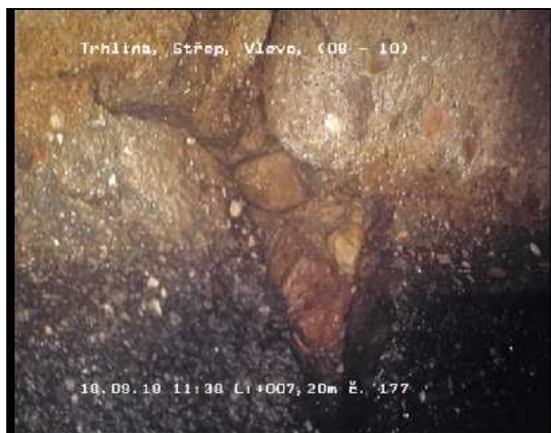
Foto 177 Videopáska: 6/2 Stav RS-L 7,20 m 8 - 10 Uhr Trhlina, Střep, Vlevo
