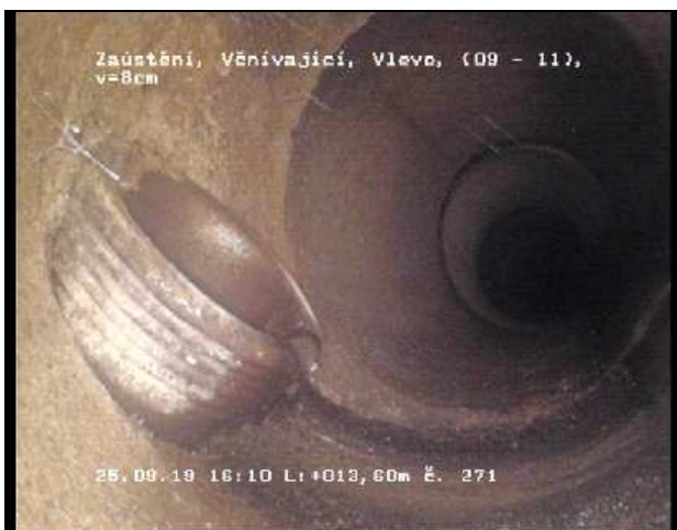
Foto 271 Videopáska: 10/6 Stav SE-L 13,60 m 9 - 11 Uhr Zaústění, Včnívající, Vlevo, Včnívající = 8cm
