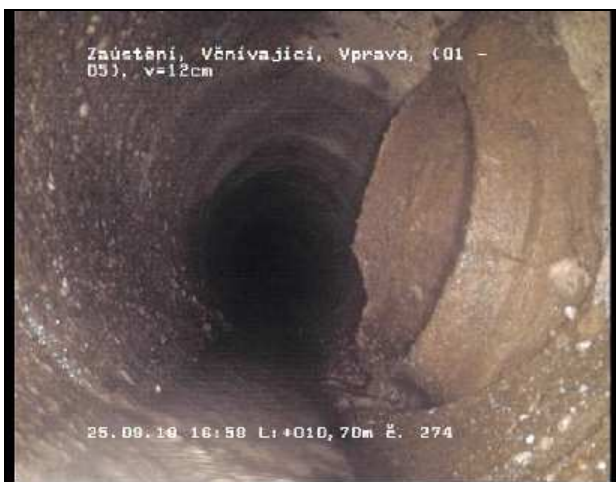
Foto 274 Videopáska: 10/7 Stav SE-R 10,70 m 1 - 5 Uhr Zaústění, Včnřivajřící, Vpravo, Včnřivajřící = 12cm
