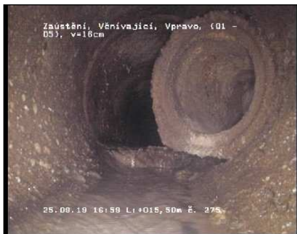
Foto 275 Videopáska: 10/7 Stav SE-R 15,50 m 1 - 5 Uhr Zaústění, Včnřivajřící, Vpravo, Včnřivajřící = 16cm
