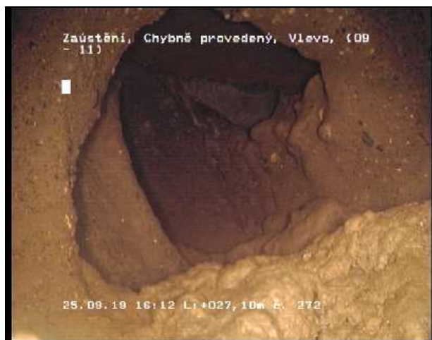
Foto 272 Videopáska: 10/6 Stav SN-L 27,10 m 9 - 11 Uhr Zaústění, Chybně provedený, Vlevo
