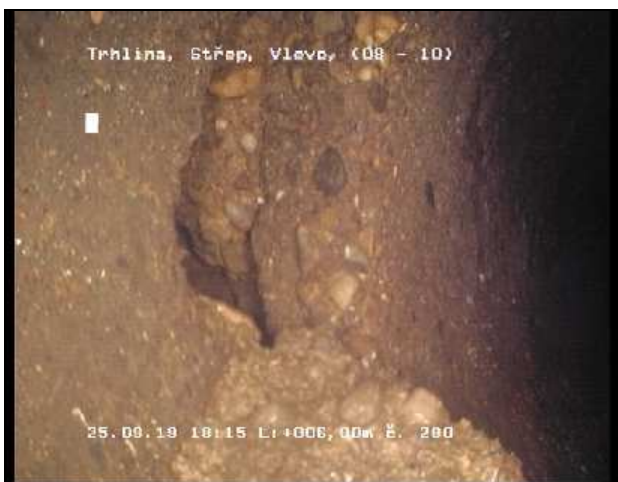
Foto 280 Videopáska: 10/9 Stav RS-L 6,00 m 8 - 10 Uhr Trhlina, Střep, Vlevo
