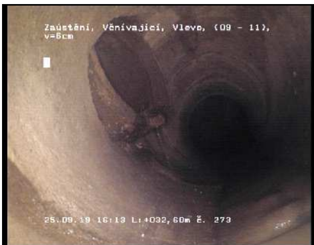
Foto 273 Videopáska: 10/6 Stav SE-L 32,60 m 9 - 11 Uhr Zaústění, Včnívající, Vlevo, Včnívající = 6cm
