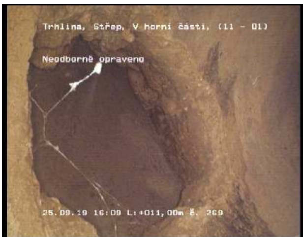
Foto 269 Videopáska: 10/6 Stav RS-O 11,00 m 11 - 1 Uhr Trhlina, Střep, V horní části; Neodborně opraveno
