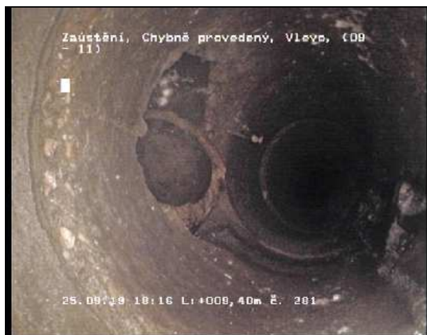
Foto 281 Videopáska: 10/9 Stav SN-L 9,40 m 9 - 11 Uhr Zaústění, Chybně provedený, Vlevo
