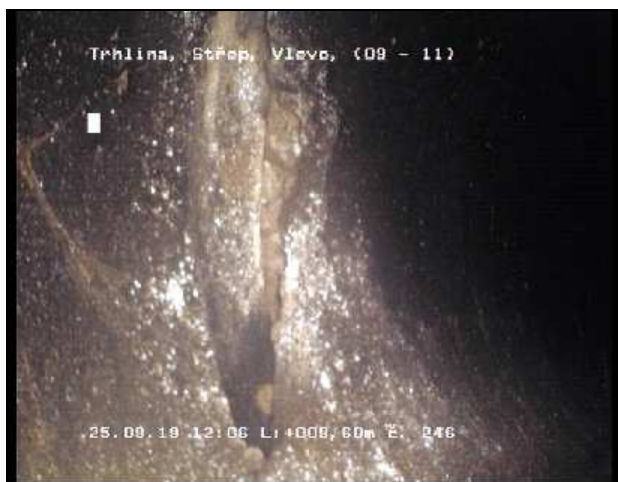
Foto 246 Videopáska: 9/4 Stav RS-L 9,60 m 9 - 11 Uhr Trhlina, Střep, Vlevo
