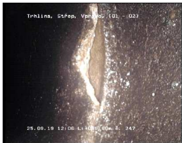
Foto 247 Videopáska: 9/4 Stav RS-R 9,60 m 1 - 2 Uhr Trhlina, Střep, Vpravo
