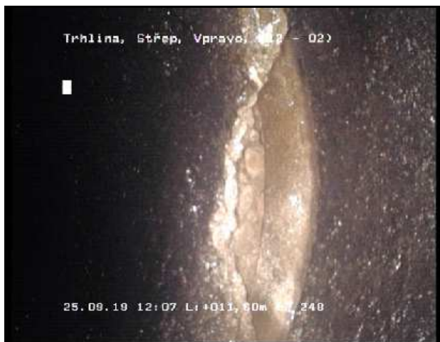
Foto 248 Videopáska: 9/4 Stav RS-R 11,60 m 12 - 2 Uhr Trhlina, Střep, Vpravo
