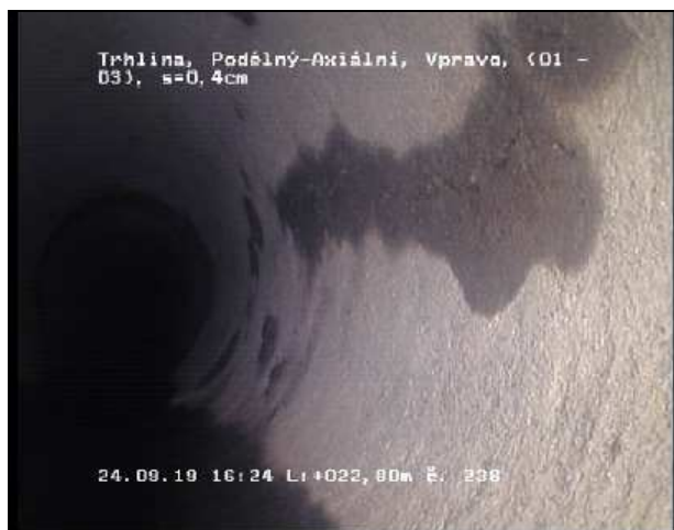
Foto 238 Videopáska: 8/4 Stav RL-R 22,80 m 1 - 3 Uhr Trhlina, Podélný-Axiální, Vpravo, Šířka trhliny = 0,40cm
