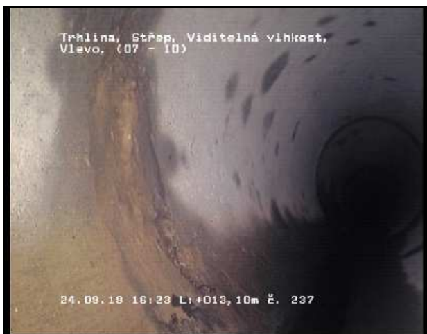
Foto 237 Videopáska: 8/4 Stav RSFL 13,10 m 7 - 10 Uhr Trhlina, Střep, Viditelná vlhkost, Vlevo
