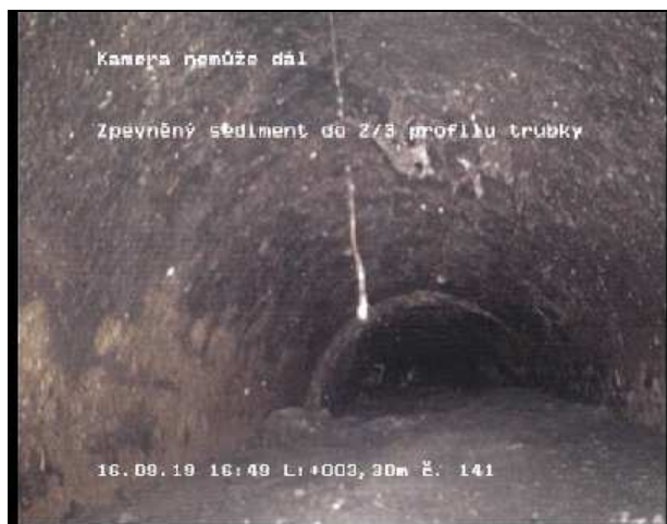
Foto 141 Videopáska 2: 5/6 Stav TVS 3,30 m Kamera nemůže dál; Zpevněný sediment do 2/3 profilu trubky
