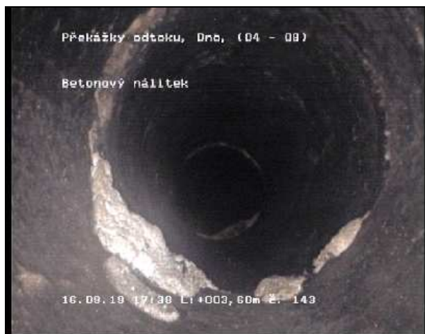
Foto 143 Videopáska: 5/7 Stav H--U 3,60 m 4 - 8 Uhr Překážky odtoku, Dno; Betonový nálipek
