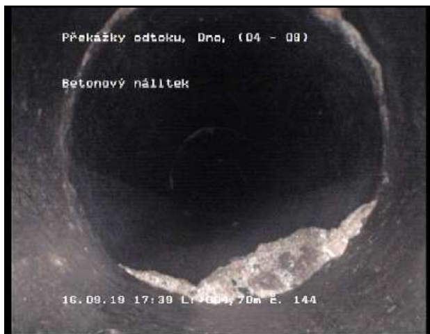
Foto 144 Videopáska: 5/7 Stav H--U 4,70 m 4 - 8 Uhr Překážky odtoku, Dno; Betonový nálipek
