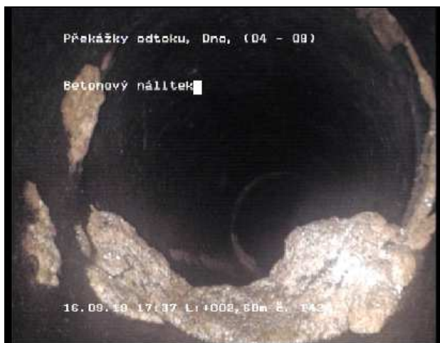
Foto 142 Videopáska: 5/7 Stav H--U 2,60 m 4 - 8 Uhr Překážky odtoku, Dno; Betonový nálipek
