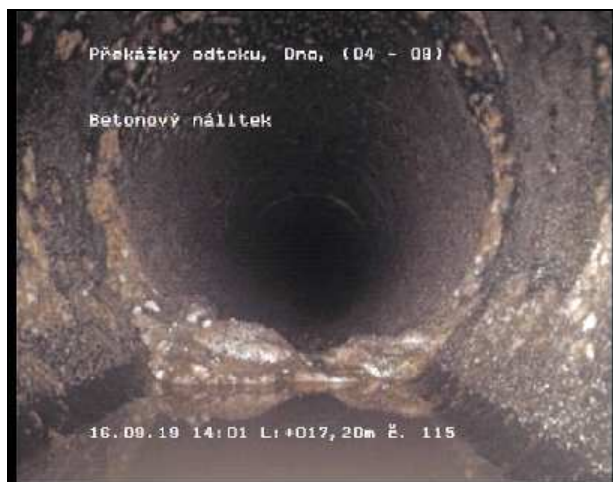
Foto 115 Videopáska: 5/1 Stav H--U 17,20 m 4 - 8 Uhr Překážky odtoku, Dno; Betonový nálipek
