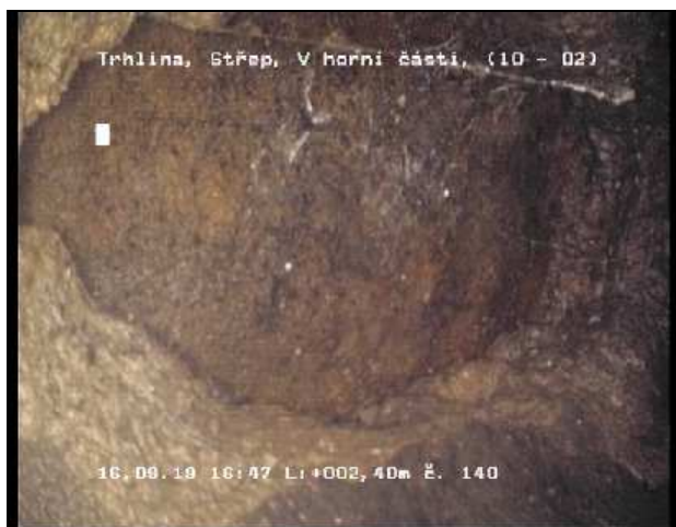
Foto 140 Videopáska 2: 5/6 Stav RS-O 2,40 m 10 - 2 Uhr Trhlina, Střep, V horní části
