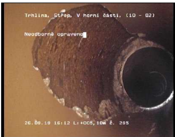
Foto 295 Videopáska: 3/13 Stav RS-O 5,10 m 10 - 2 Uhr Trhlina, Střep, V horní části; Neodborně opraveno
