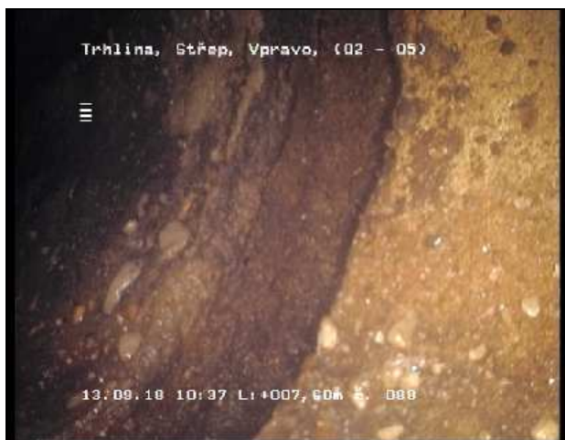
Foto 088 Videopáska: 3/5 Stav RS-R 7,60 m 2 - 5 Uhr Trhlina, Střep, Vpravo
