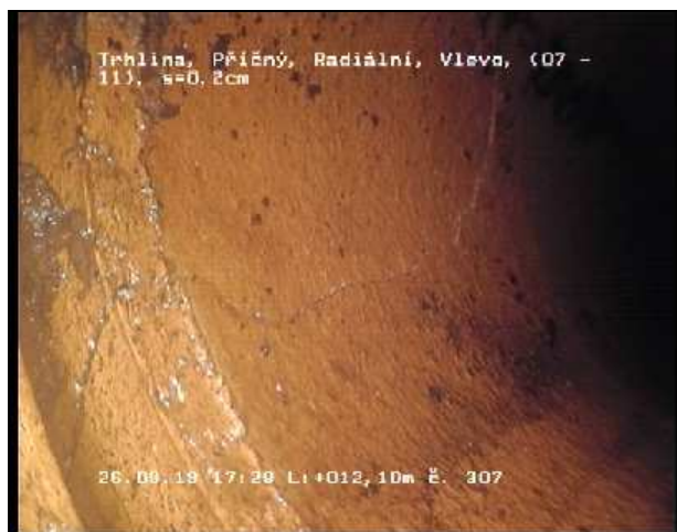
Foto 307 Videopáska: 3/16 Stav RQ-L 12,10 m 7 - 11 Uhr Trhlina, Příčný, Radiální, Vlevo, Šířka trhliny = 0,20cm
