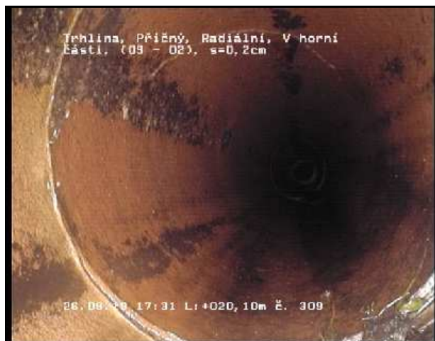
Foto 309 Videopáska: 3/16 Stav RQ-O 20,10 m 9 - 2 Uhr Trhlina, Příčný, Radiální, V horní části, Šířka trhliny = 0,20cm
