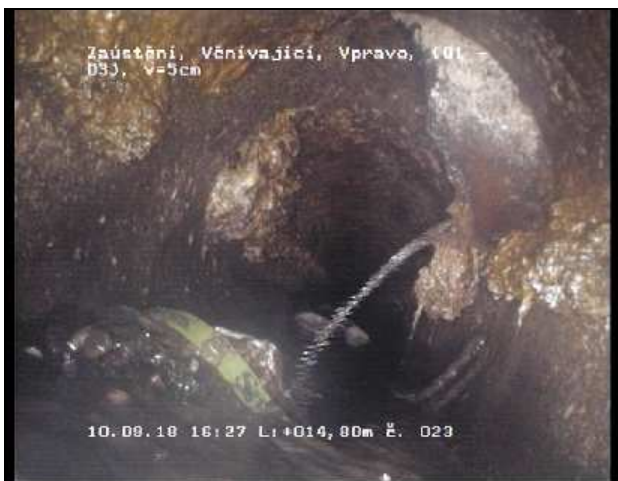
Foto 023 Videopáska: 1/9 Stav SE-R 14,80 m 1 - 3 Uhr Zaústění, Včnívající, Vpravo, Včnívající = 5cm
