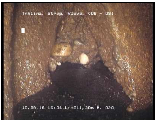
Foto 020 Videopáska: 1/8 Stav RS-L 11,30 m 6 - 9 Uhr Trhlina, Střep, Vlevo
