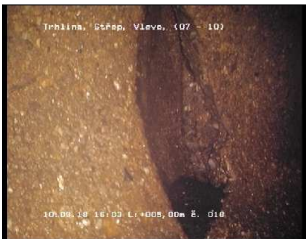
Foto 018 Videopáska: 1/8 Stav RS-L 5,00 m 7 - 10 Uhr Trhlina, Střep, Vlevo
