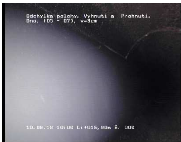
Foto 006 Videopáska: 1/2 Stav LB-U 15,90 m 5 - 7 Uhr Odchylka polohy, Vyhnutí a Prohnutí, Dno, Vyhnutí = 3cm; V délce od 15,90 do 18,70m
