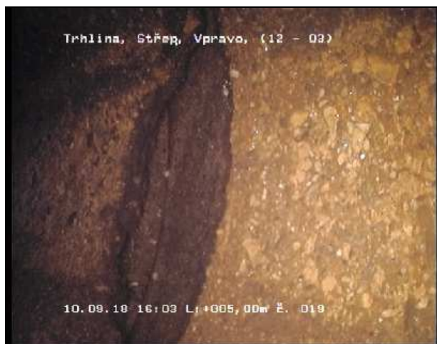
Foto 019 Videopáska: 1/8 Stav RS-R 5,00 m 12 - 3 Uhr Trhlina, Střep, Vpravo
