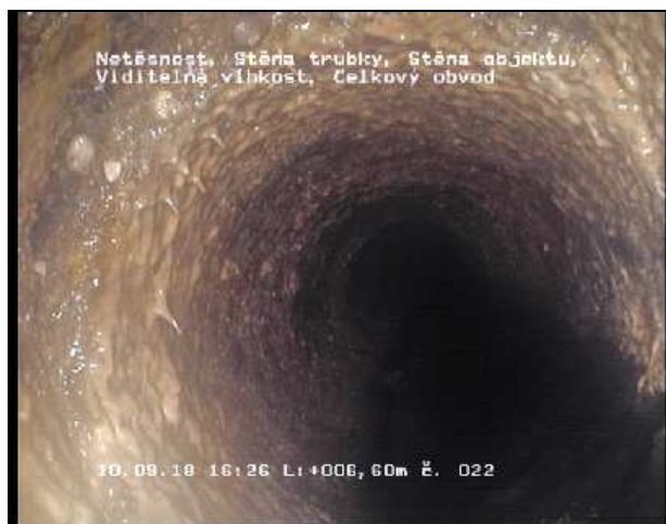
Foto 022 Videopáska: 1/9 Stav UWF- 6,60 m Netěsnost, Stěna trubky, Stěna objektu, Viditelná vlhkost, Celkový obvod
