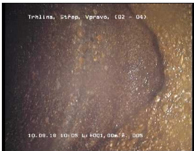
Foto 005 Videopáska: 1/2 Stav RS-R 1,00 m 2 - 4 Uhr Trhlina, Střep, Vpravo
